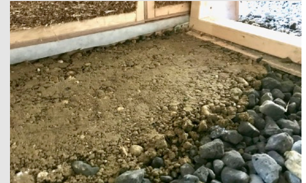
Na penové sklo sa spravi vrstva hlinenej podlahy. Ak má byť hlinená vrstva vzduchotesná, musí byť homogénna a súvislá, s napojením na steny.
