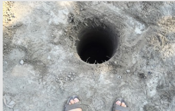
Hĺbka a rozstupy medzi pilótami boli rečítané statikom pre konkrétne geologické podložie.
