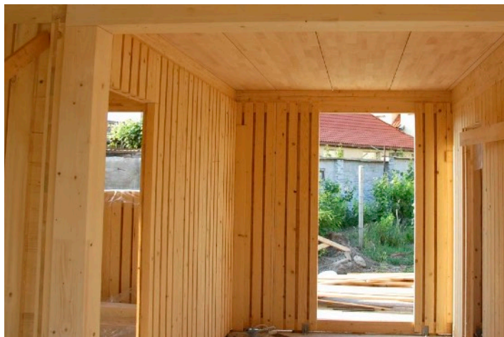
Priečky z drevených panelov. Na obrázku sú nosné priečky Lignotrend kde panely s medzerami umožňujú rozvod inštalácií na stavbe. Pohľadové plnodrevené CLT (Croos Laminated Timber) panely musia mať elektrickú inštaláciu zadanú už pri výrobe.
